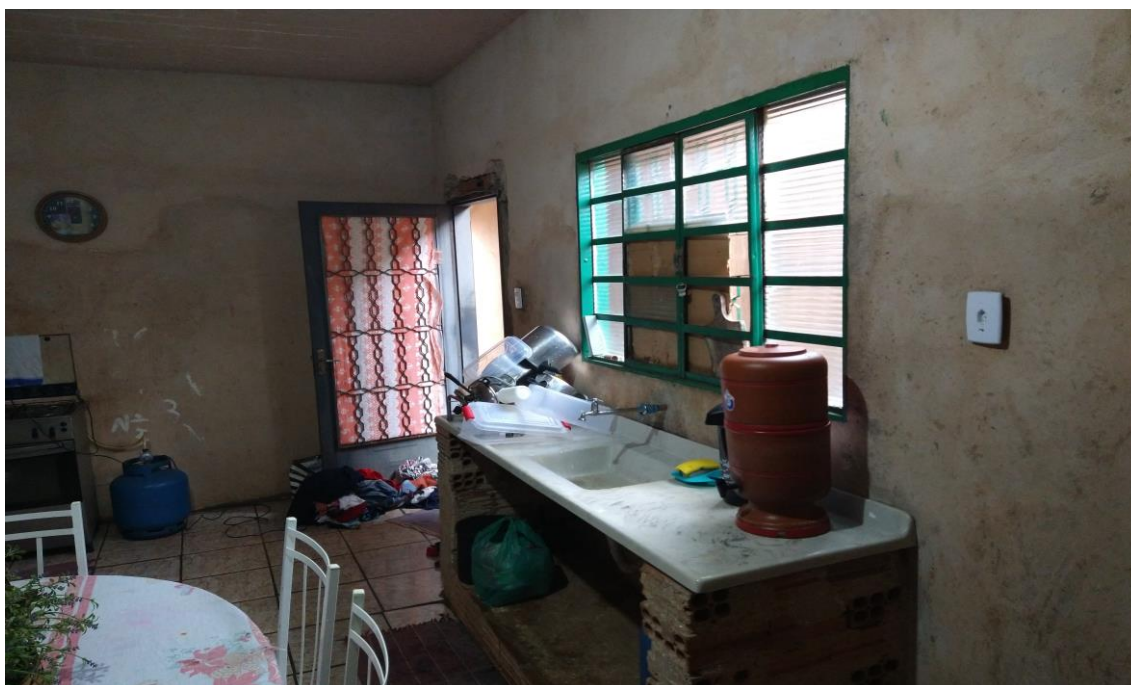
FOTO nº. 6 - RESIDÊNCIA: COZINHA DETALHE: Ausência de pintura.
