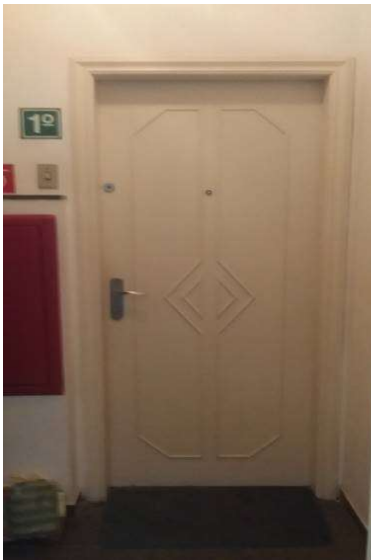
FOTO Nº 10 – Vista da porta do apartamento nº 11, objeto da ação.
