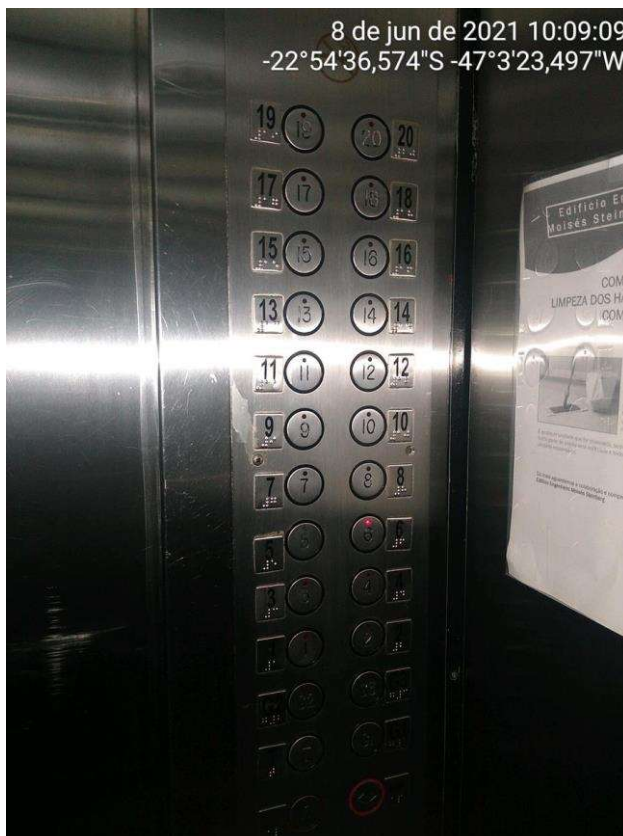
FOTO 09 – PAINEL DO ELEVADOR
